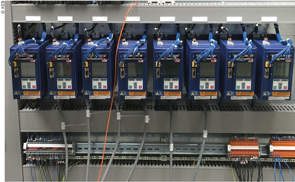
Mise en place de variateurs de fréquences pour amélioration des cycles machines et de la consommation générale. La gestion de rampes d'accélération permet une forte économie d'énergie comparée à des démarrages directs.
